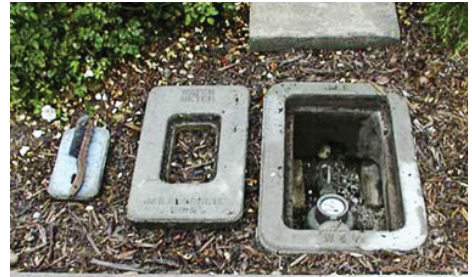
Figura 5-7: Medidor de agua
