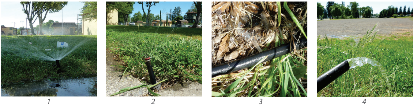
Figura 6-2: De izquierda a derecha (1) y (2) cabezales torcidos, (3) emisor de riego por goteo faltante, (4) tubería de riego por goteo cortada
