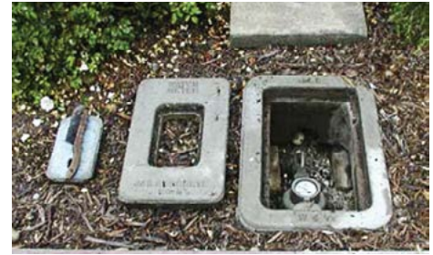
Figura 5-7: Medidor de agua
