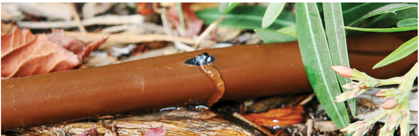
Figura 5-17: Tubería de Riego por Goteo (imagen es cortesía de Rain Bird Corporation)
