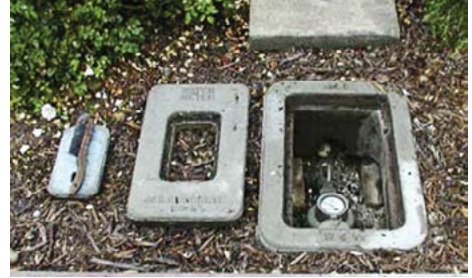
Figura 5-7: Medidor de agua
