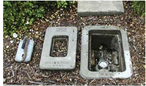
Figura 5-7: Medidor de agua
