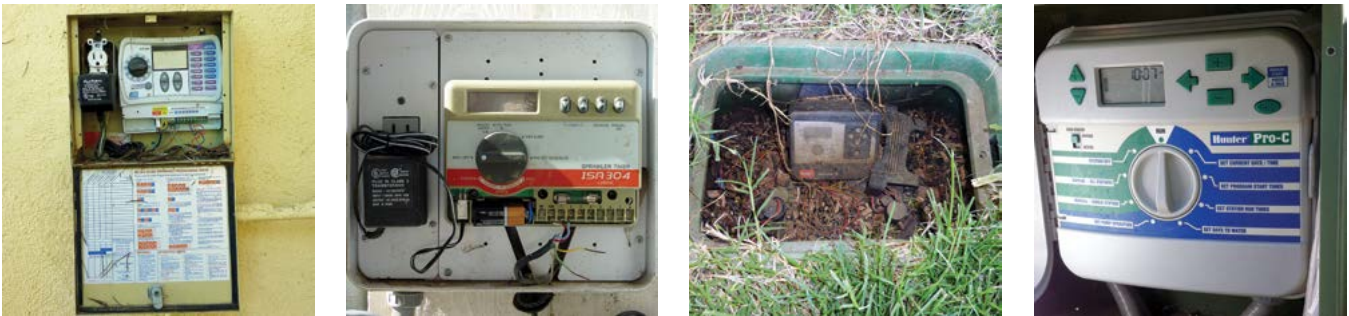
Figura 6-1: Varios ejemplos de controladores en su lugar de operación
