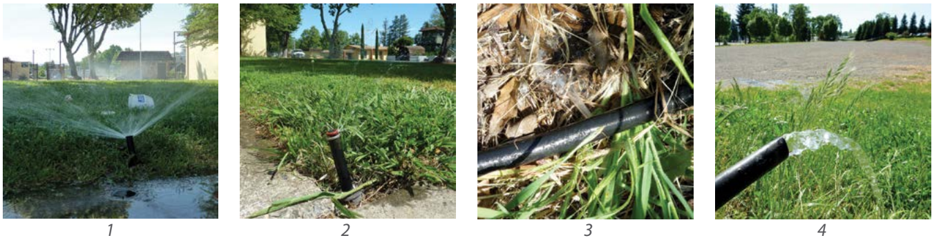
Figura 6-2: De izquierda a derecha (1) y (2) cabezales torcidos, (3) emisor de riego por goteo faltante, (4) tubería de riego por goteo cortada
